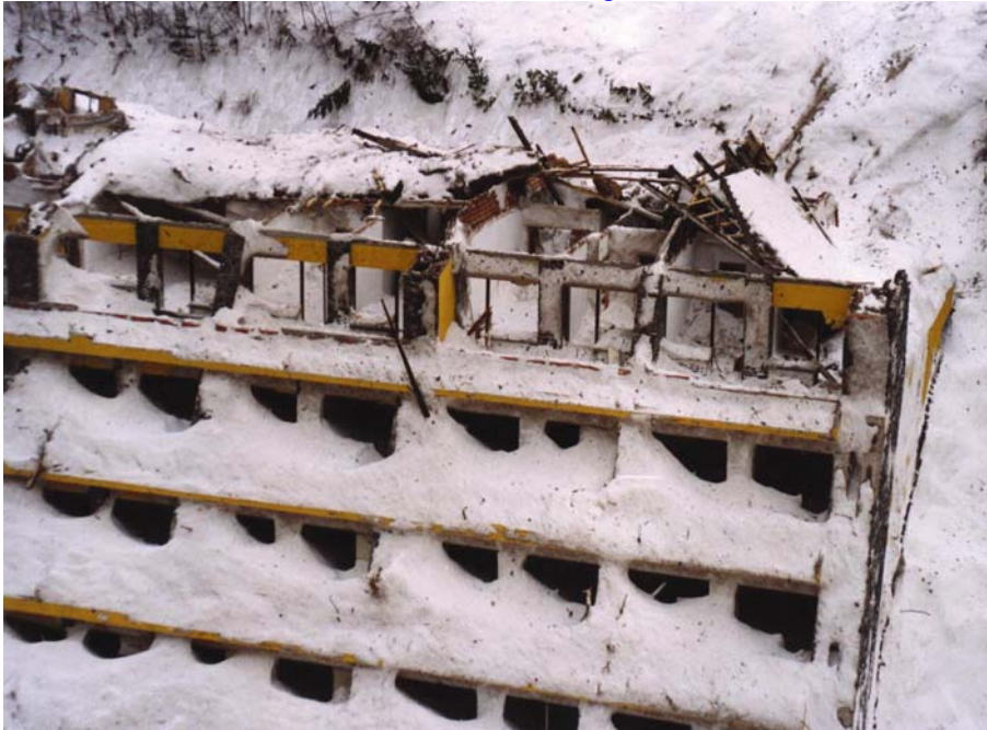
Photo 5-17. Avalanche d'Arinsal en Andorre du 8 février 1996 Le toit d'un immeuble de 6 étages
